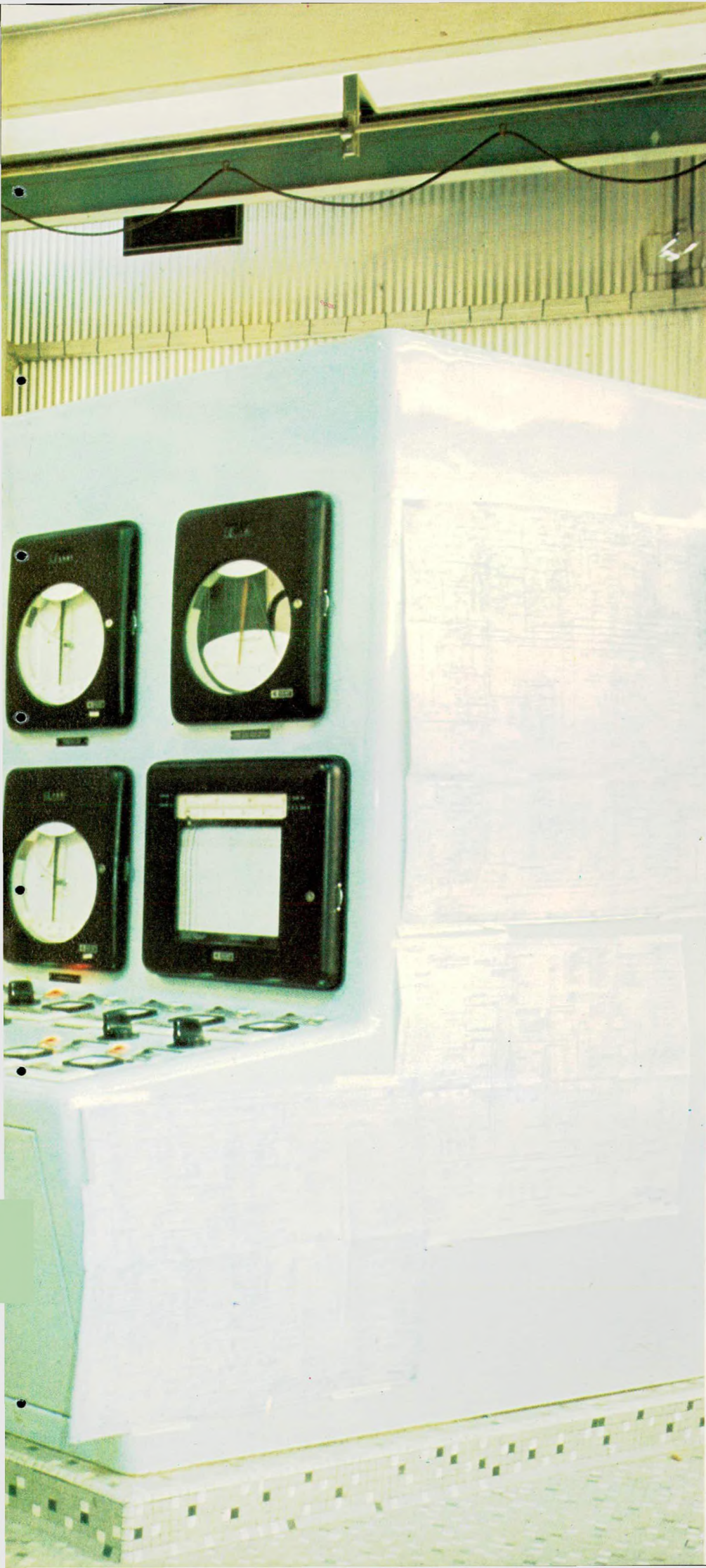
Panel Kawalan Tarbin Yunit No. 6 Stesyen Janaelektrik Sultan Ismail Johor Baru. Projek ini pada keseluruhannya dijurutera- kan oleh jurutera-jurutera Lembaga sendiri.
