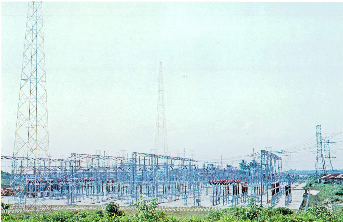
Pemutus Litar 132KV di Bukit Rajah, Kelang.
