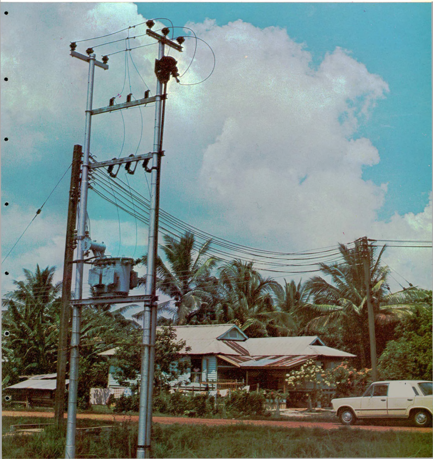
Pencawang elektrik luar bandar atas tiang yang lazim.
