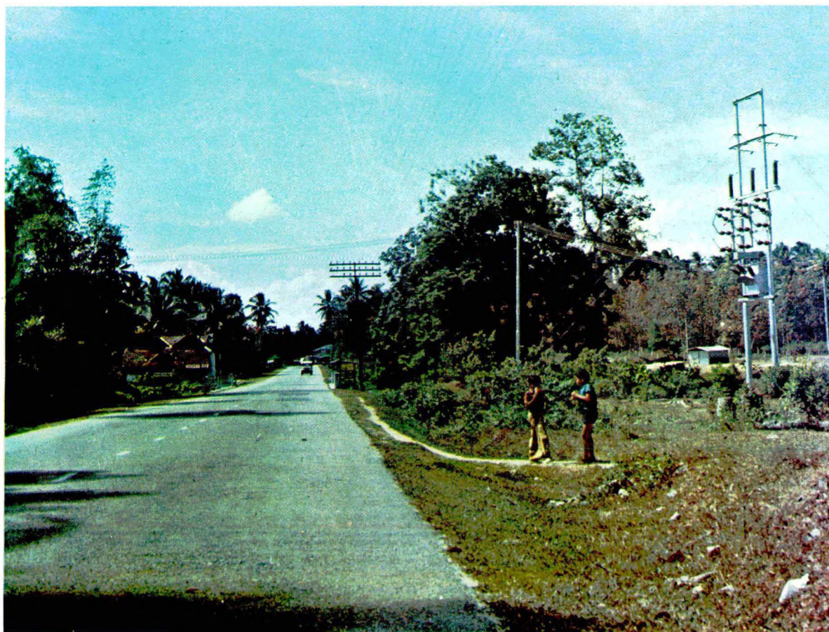
Sebuah Pencawang yang dilekap di Tiang 33/.433 kV 50 kVA memberi bekalan di sebuah Kampung -di Kuantan.
