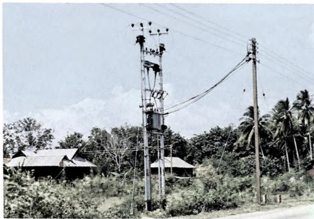
Pencawang elektrik atas tiang yang biasa digunakan di kawasan luar bandar.
