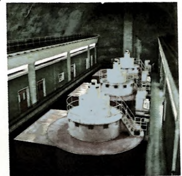
7 Stesen Janaelektrik Sultan Idris II 150 MW
